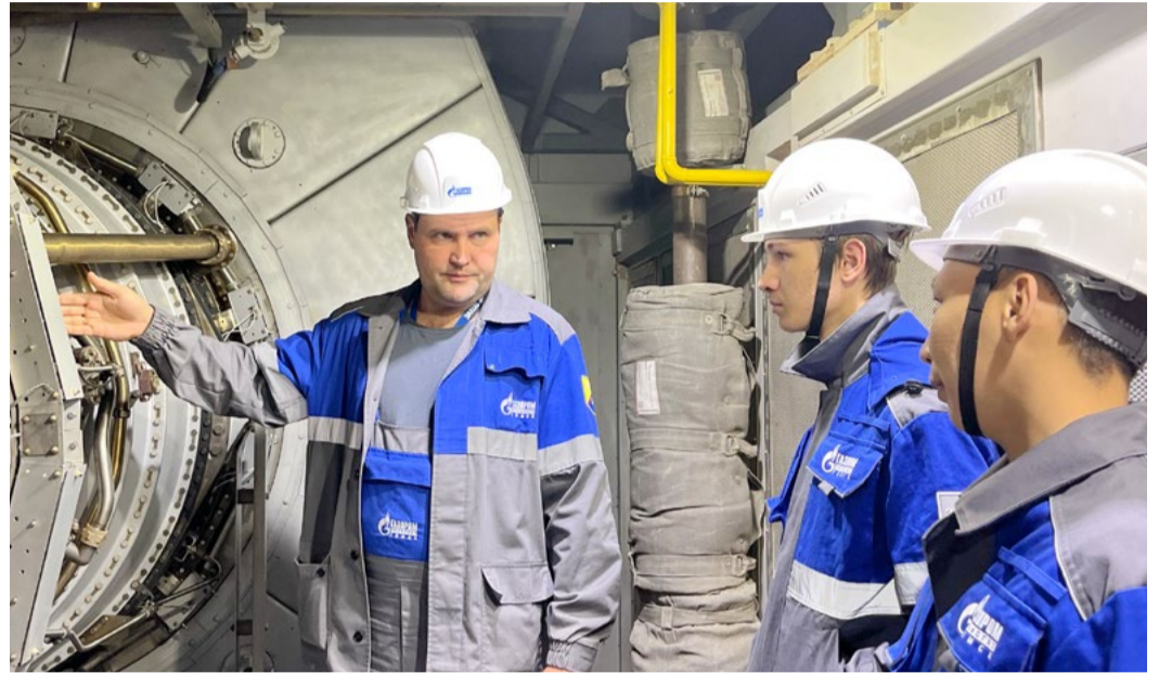
Ленск: знакомство с устройством газоперекачивающего агрегата
