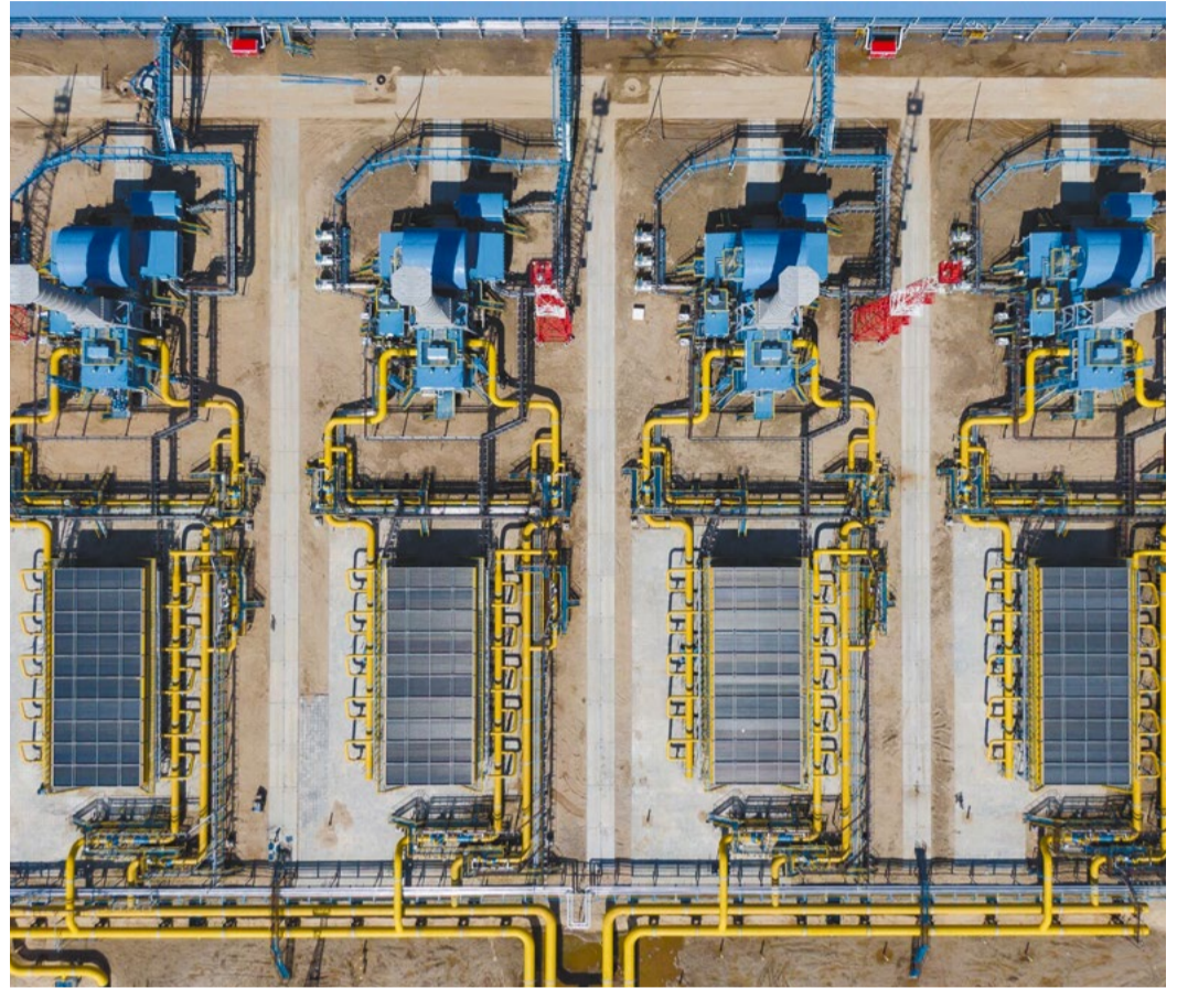
Газоперекачивающие агрегаты компрессорной станции «Пётр Бекетов»
