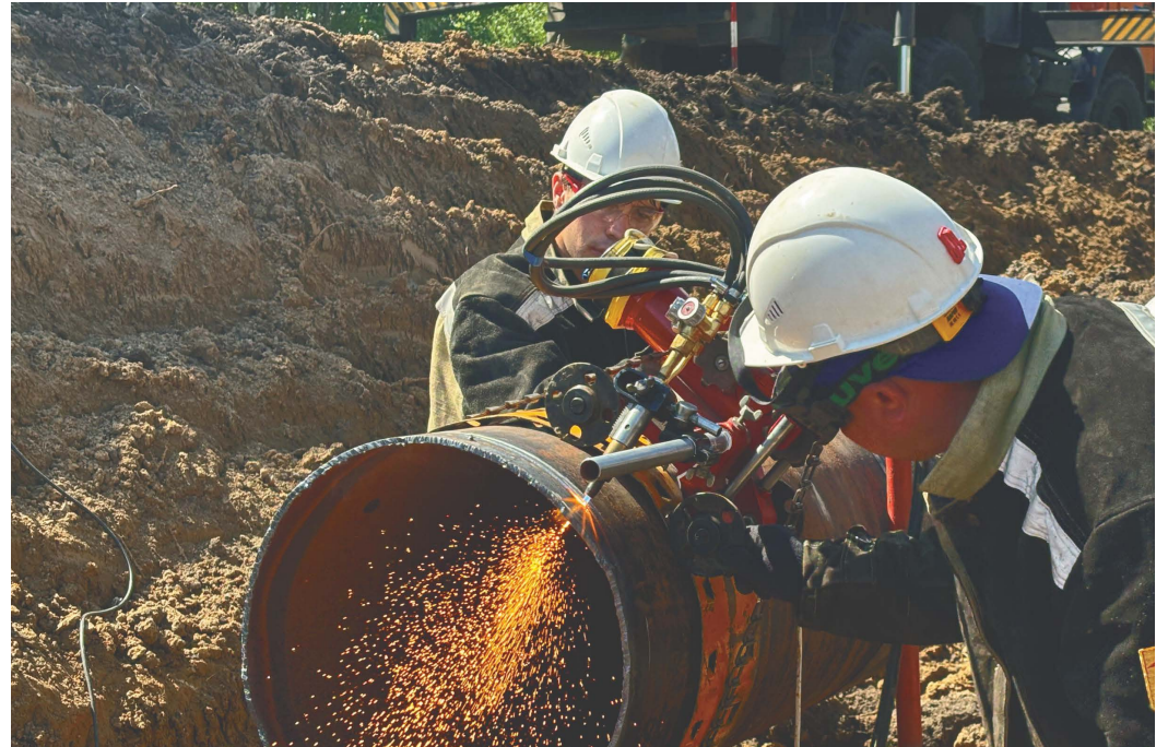
Специалисты Томского филиала устранили три дефекта путем вырезки катушки
