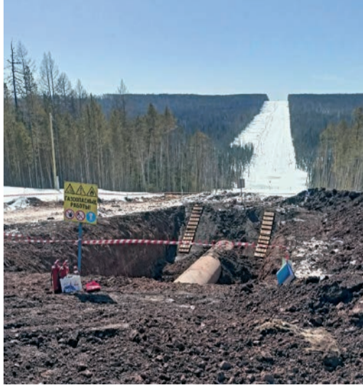
Залог успешного прохождения осенне-зимнего периода — качественная подготовка
